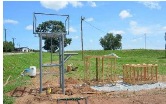
Abbildung 70: Aufstellung der Gerüste: Metallgerüst mit Betonfundament (li.), Holzgerüste auf begradigter Plattform, um vor Nässe zu schützen (R. Voß)
