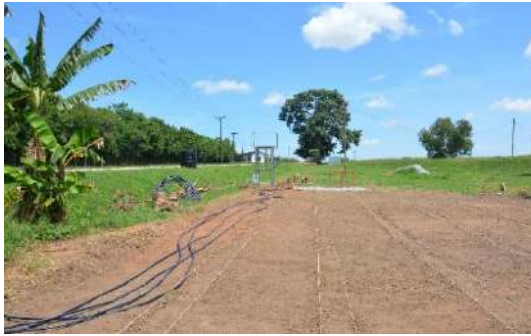
Abbildung 69: Versuchsgelände in der Vorbereitung. Im Vordergrund: Feld für die Bewässerungsversuche, Im Hintergrund: Bau der Gerüste für das Filtersystem (R. Voß)
