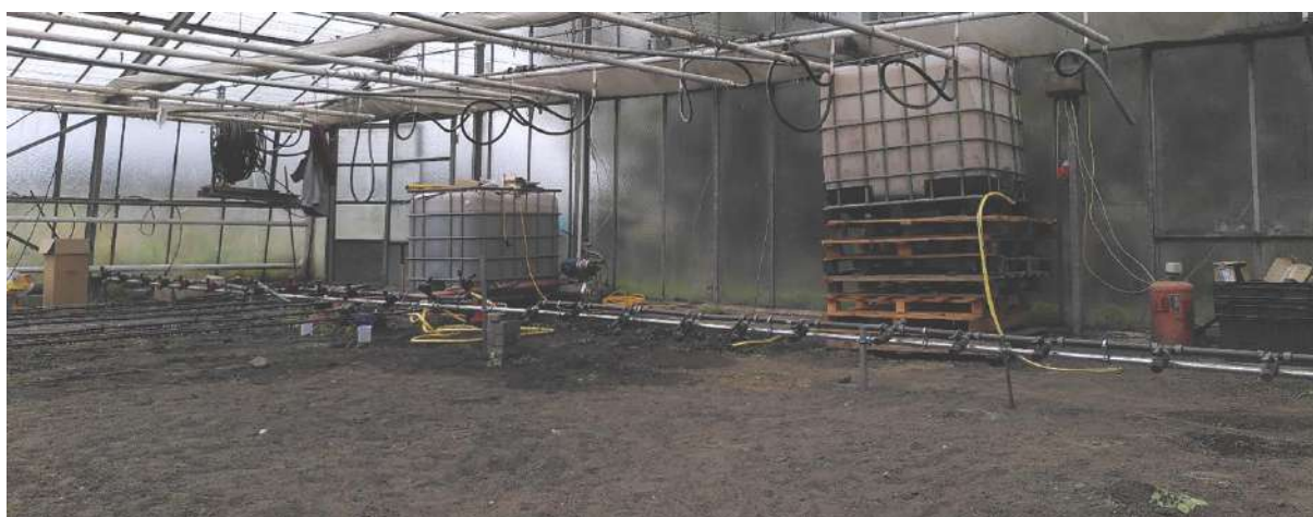
Abbildung 80: Grundgerüst der Versuchsanlage im Gewächshaus Neuenkirchen
