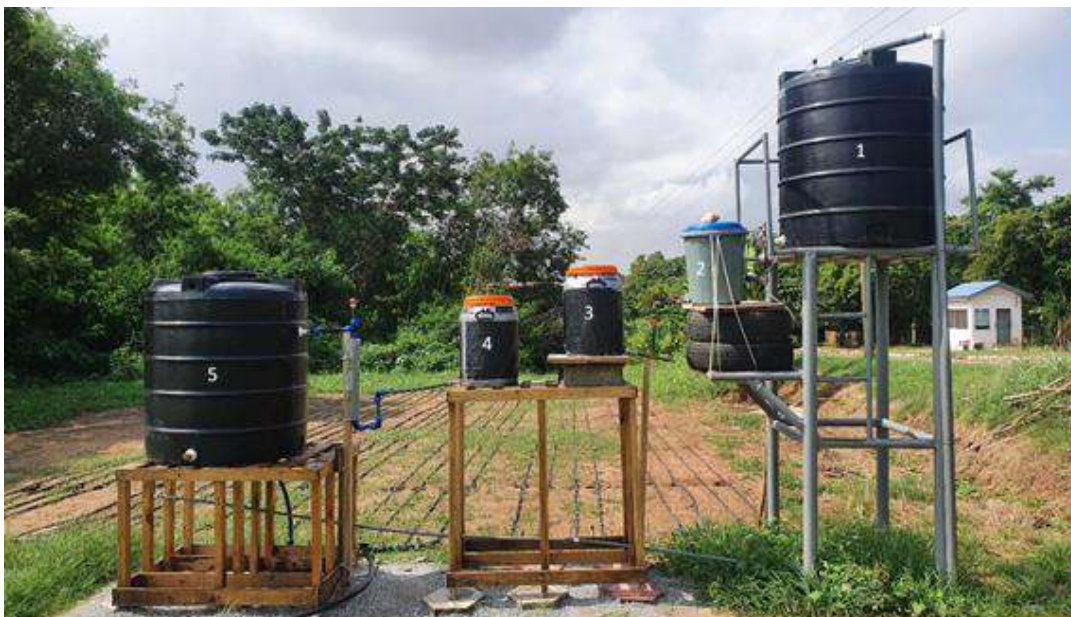
Abbildung 60: Kleintechnisches Biokohle-Filtersystems (S.Krüger).
