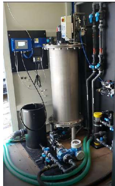
Abbildung 55: Ausschnitt der AWAS-Containeranlage mit PP-Filter und UV-Vis Spektrometersystem.
